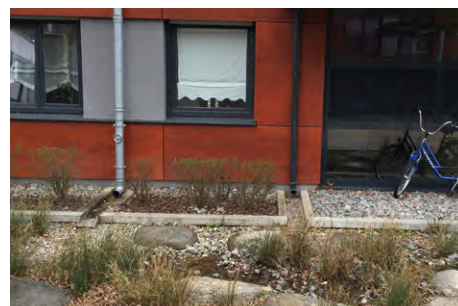
Exemple de gouttières débranchées
